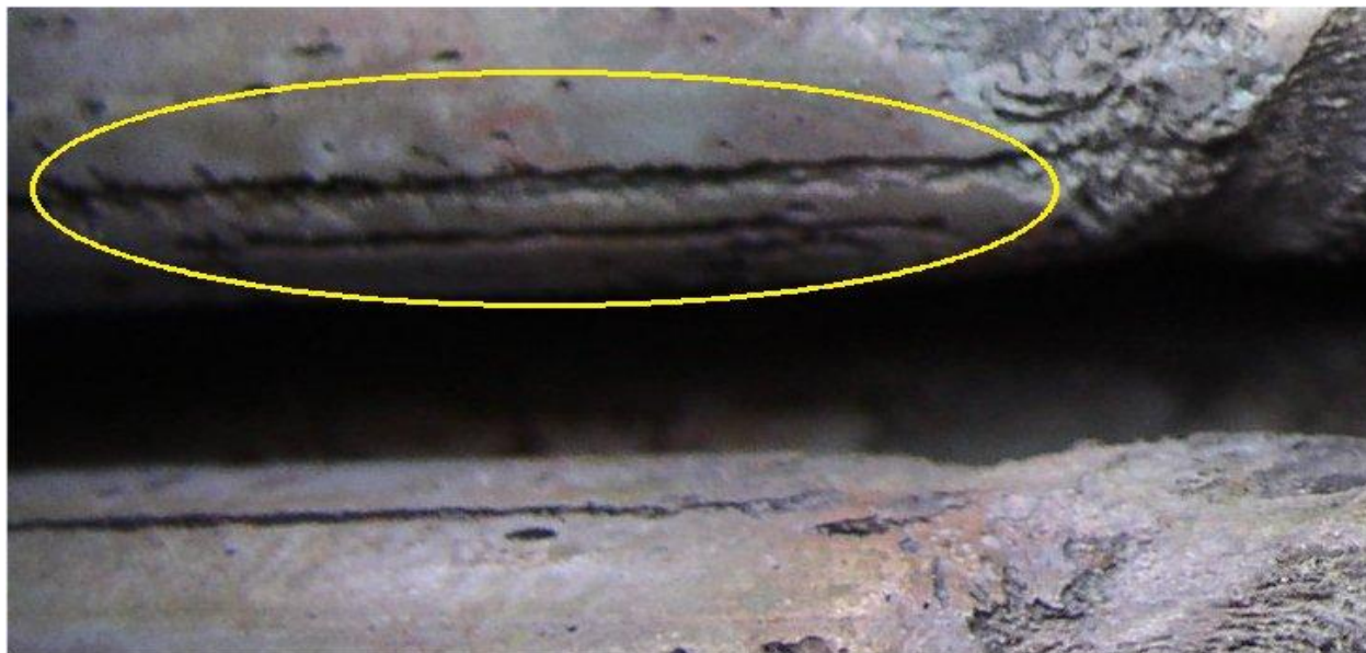
Obr .9: Svařovaná trubka 8x0,6, 1.4404, Projev koroze v teplotně ovlivněné oblasti okolí svaru, která je ochuzena o chrom, a navíc vystavena nepřiměřeně agresivnímu roztoku obsahujícímu chloridy. Charakteristický projev korozně-erozního napadení (Zvětšeno cca 20x)
