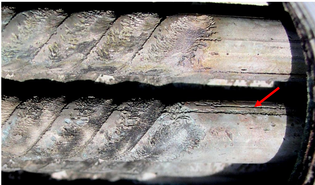
Obr.18: Vliv přechlorované bazénové vody a typické korozně-erozní opotřebení. Rychlost proudění zde měla nezanedbatelný vliv. Povrch důlků je bez korozních produktů. Dobře je vidět průběh koroze ve zcitlivěné oblasti v okolí svaru trubky. Zajímavá je jednostranná ostrá hrana, která se vytvořila na vrcholcích vln-vrubování použité vrubované trubky.
