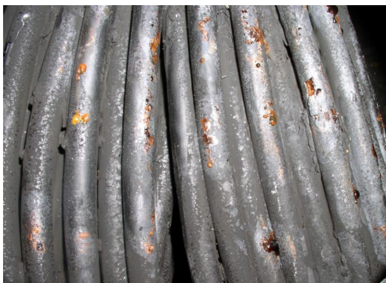
Obr.5: Korozní produkty kryjící korozní důlky na trubkách.
