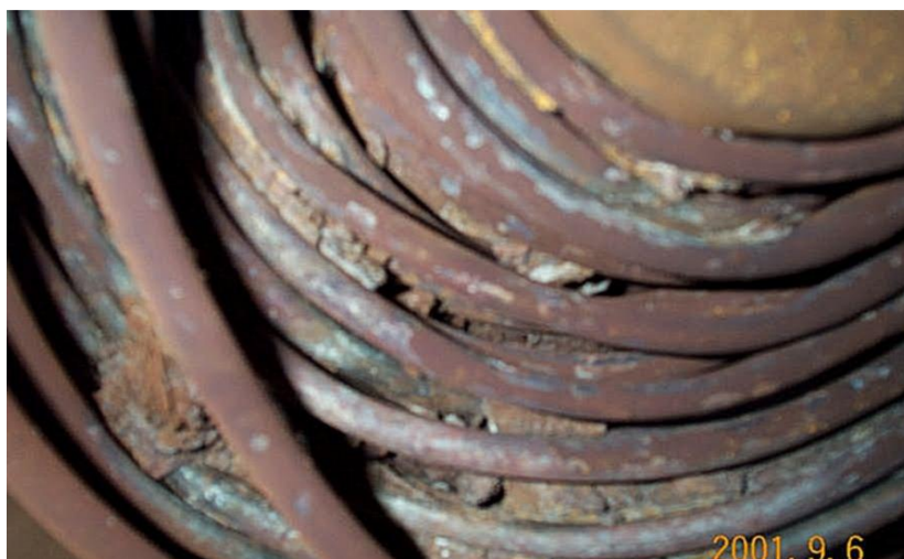
Obr. 30: Zanesení kotelním kamenem a následky koroze v mezitrubkovém prostoru výměníku při ohřevu systému ÚT parou, v místě největšího rozdílu teplot.
