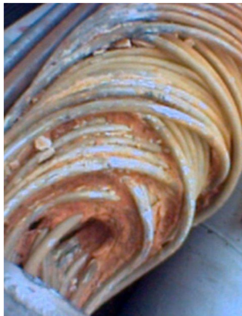
Obr.21: Trubkový svazek výměníku zaneseného kotelním kamenem v místě největšího rozdílu teplot. (Oblast Ústí nad Labem)
