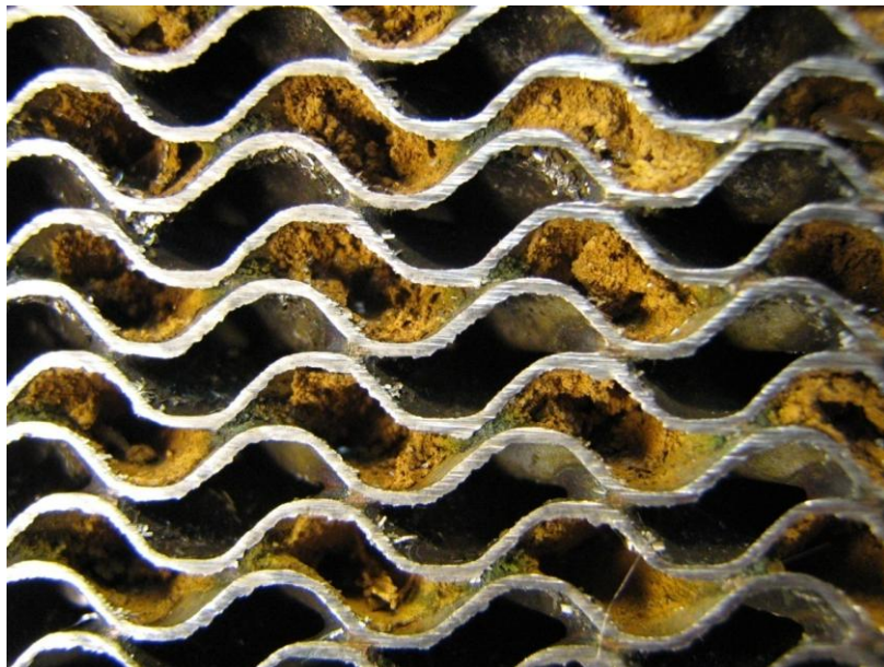
Obr.25 : "Zacpání" pracovního prostoru pájeného deskového výměníku nerozpustnými částicemi (jemný prach a písek) Snímek napříč rozříznutého pájeného deskového výměníku.
